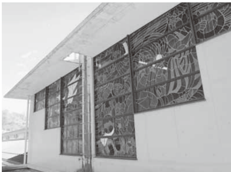
老朽化した川俣小学校玄関ホール軒天
