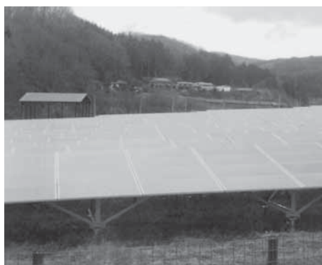
山木屋地区太陽光発電パネル
