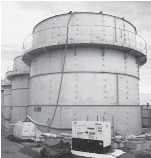
汚染水漏れが確認された貯蔵タンク (東京電力福島第一原子力発電所)
