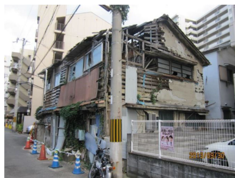
図 35. 屋根・外壁の脱落や、倒壊した場合の周辺の建築物や通行人等への被害が切迫している状態
