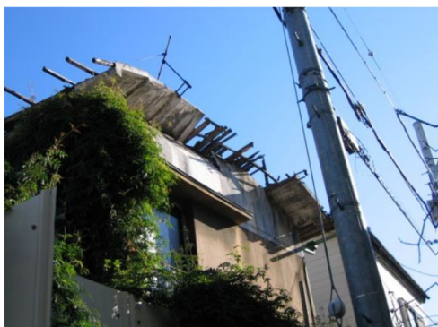
図 33. 樹木の枝等が前面道路にはみ出しており、歩行者等に影響するおそれがある状態
