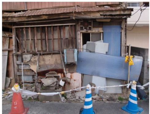
図 32. 外壁等が脱落したまま放置されており、景観を損なっている状態
