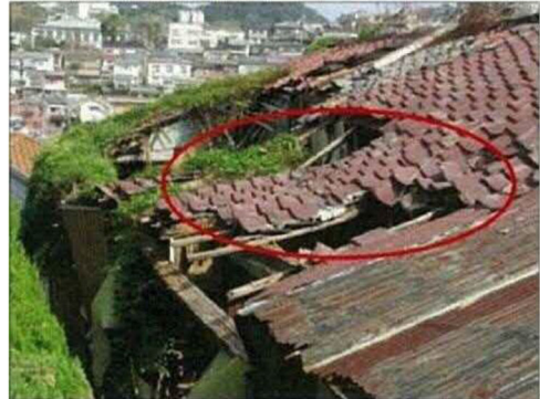
図 31. 建築物の破損等が原因で汚物、排水の流出や臭気の発生のおそれがある状態
