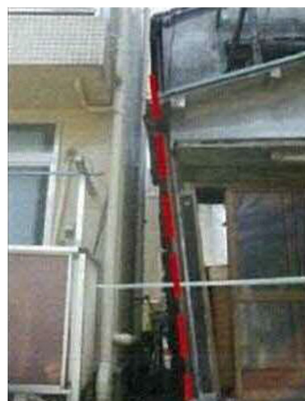
図 30. 倒壊等により隣家に影響するおそれがある状態
