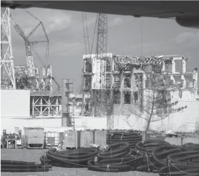
大きく損壊した原子炉建屋（東京電力福島第一原子力発電所）
