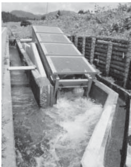
農業用水路を利用した小水力発電（岐阜県郡上市）
