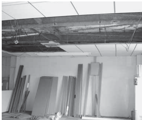
地震により使用不能となった役場庁舎（情報管理室）
