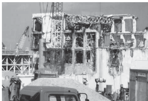
大きく損壊した原子炉建屋
