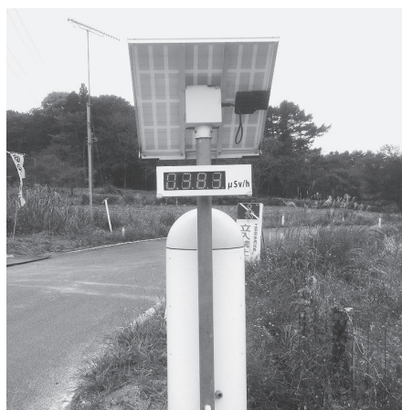
1年ぶりに再設置されたモニタリングポスト
