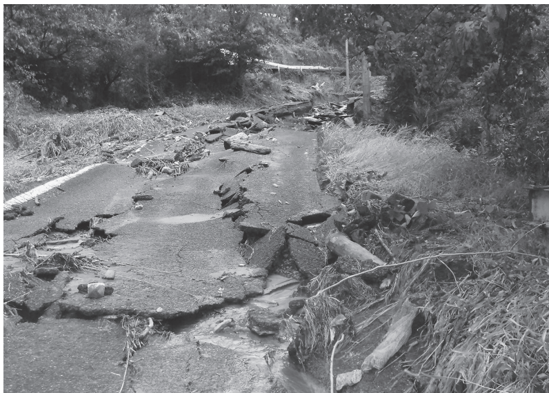
現在も不通になっている町道長滝若松線
