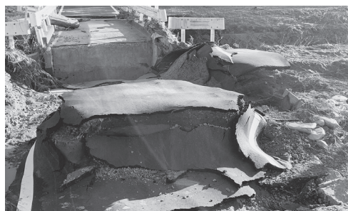
大規模な被害を受けた町道（山木屋・菅ノ又地区）
