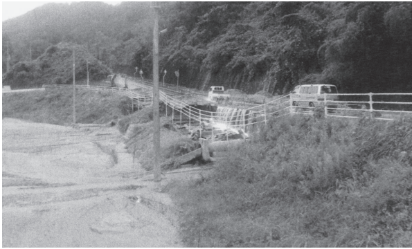
国道349号道路が崩落した小島字杉田地内
