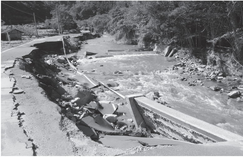
たびたび広瀬川決壊の被害を受ける小島地区（関口地内）
