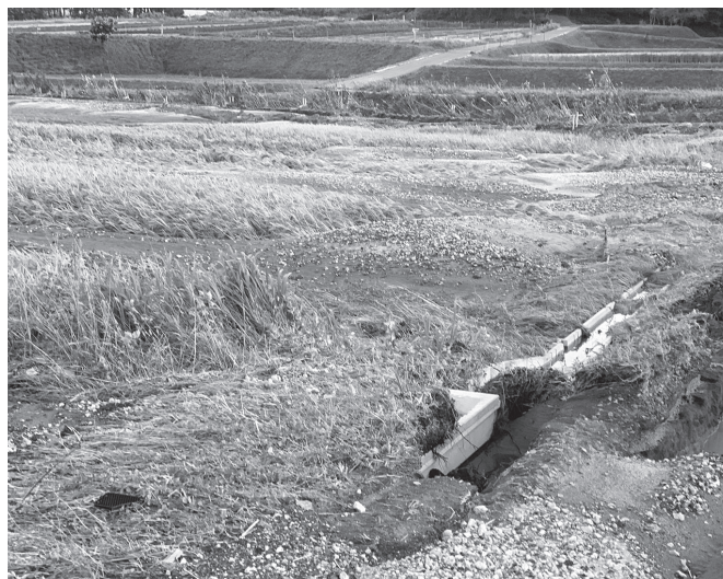
営農再開し台風被害を受けた山木屋地区の水田
